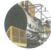
GERADOR DE VAPOR
